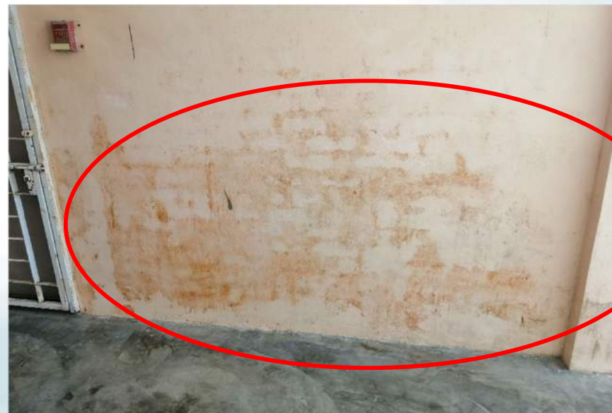
Dinding tidak bersih dan terdapat kesan wap air
